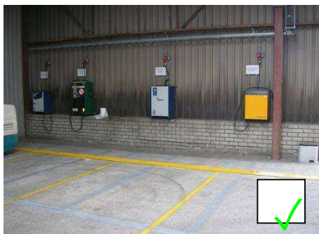
Aparte ruimte van voldoende omvang voor opladen. Units voldoende uit elkaar.
