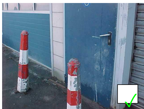
Deuren, toegang: signaleren deuren naar tasveld
