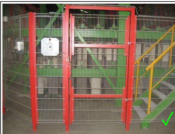
Toegang tot gripper die lege cassettes oppakt afgeschermd met hekwerk en contactschakelaar
