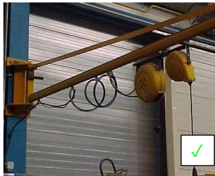
Zwenkarm plaatsen om lucht en elektriciteit aan te hangen (geen snoeren op de vloer)
